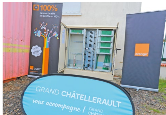
Rue Louis Braille, la 63 e et dernière « armoire de rue » est désormais opérationnelle. Aujourd'hui, 12 030 logements sur 18 322 sont directement raccordables à la fibre optique Orange, soit 66% des habitations de Châtelleraut.
